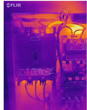
Identificar fallos eléctricos
