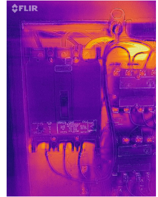
发现电气故障
